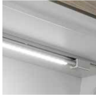
Energiezuinige LED-verlichting in het interieur.
